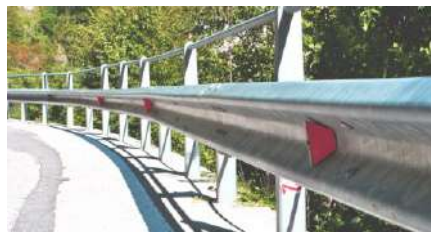
ガードレール
