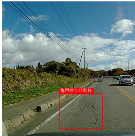
亀甲状ひび割れ
